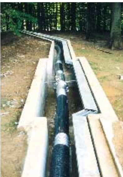
Lange Transferleitungen für LOX Long Transfer Lines for LOX
