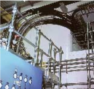
Transferleitungen bei CERN in Genf Transfer Lines at CERN in Geneva
