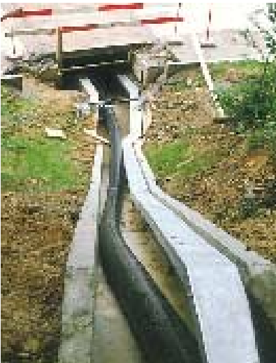
Lange Transferleitungen für LOX Long Transfer Lines for LOX
